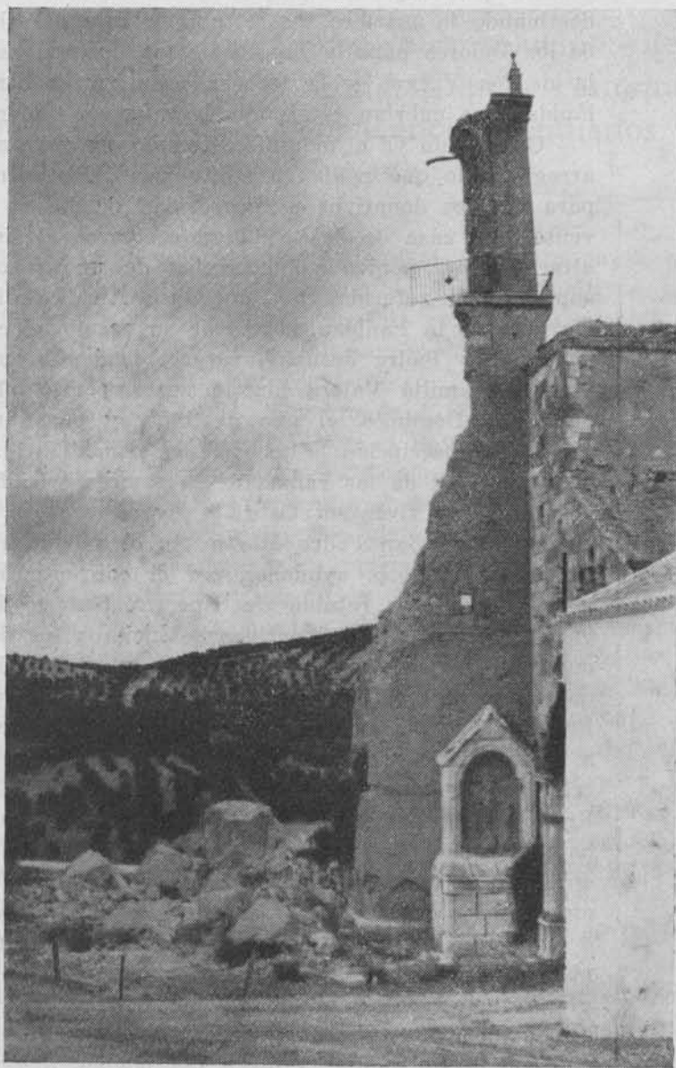
Restos actuales de la torre después del derrumbamiento
