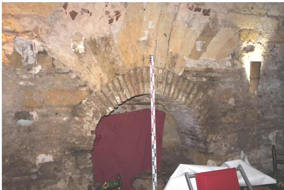
Fig. 7. Detalle de los arcos y aparejos de la pared suroeste de la sala caliente. (Foto: J. M. Tamajón)
